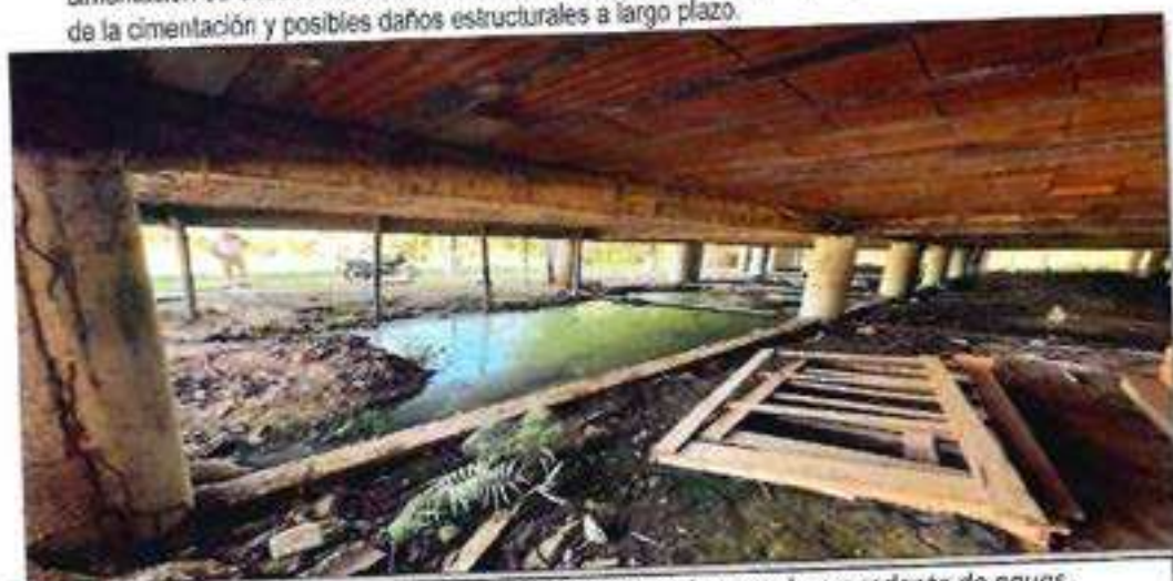
Imagen 07. El sótano se encuentra con el terreno natural saturado procedente de aguas pluviales.
