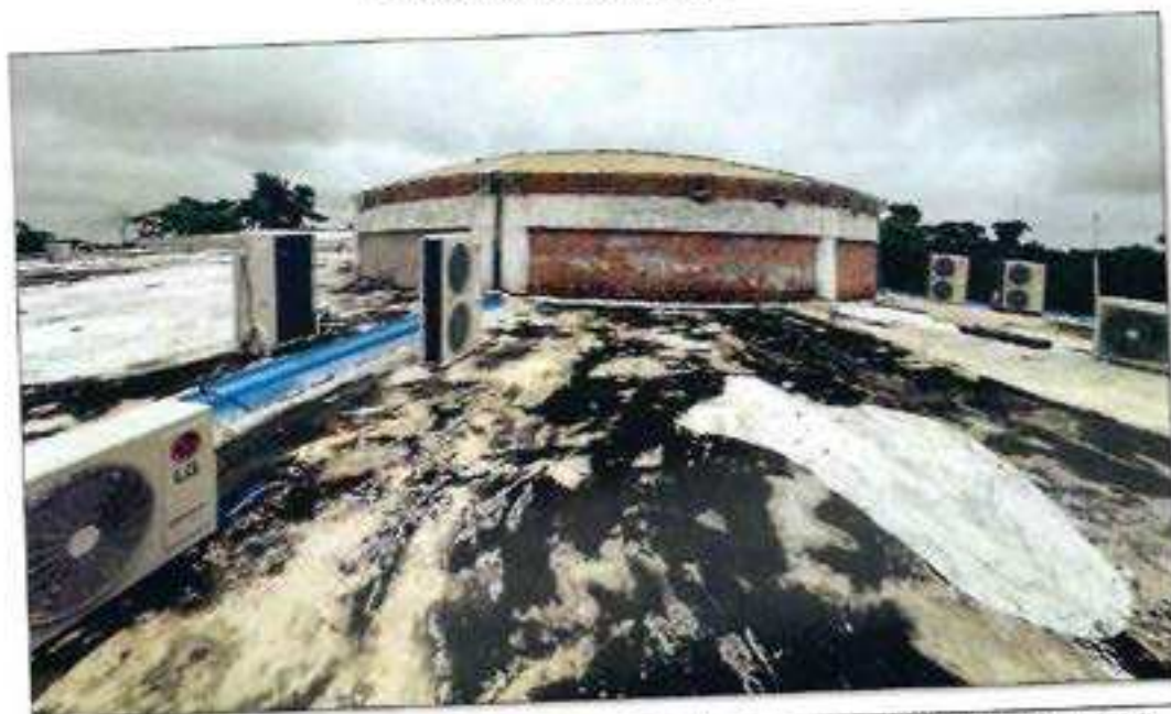
Imagen 06. Los condensadores de los aires acondicionados se encuentran en la intemperie, sin una coseta de seguridad, causando que algunos aires acondicionados estén malogrados.
