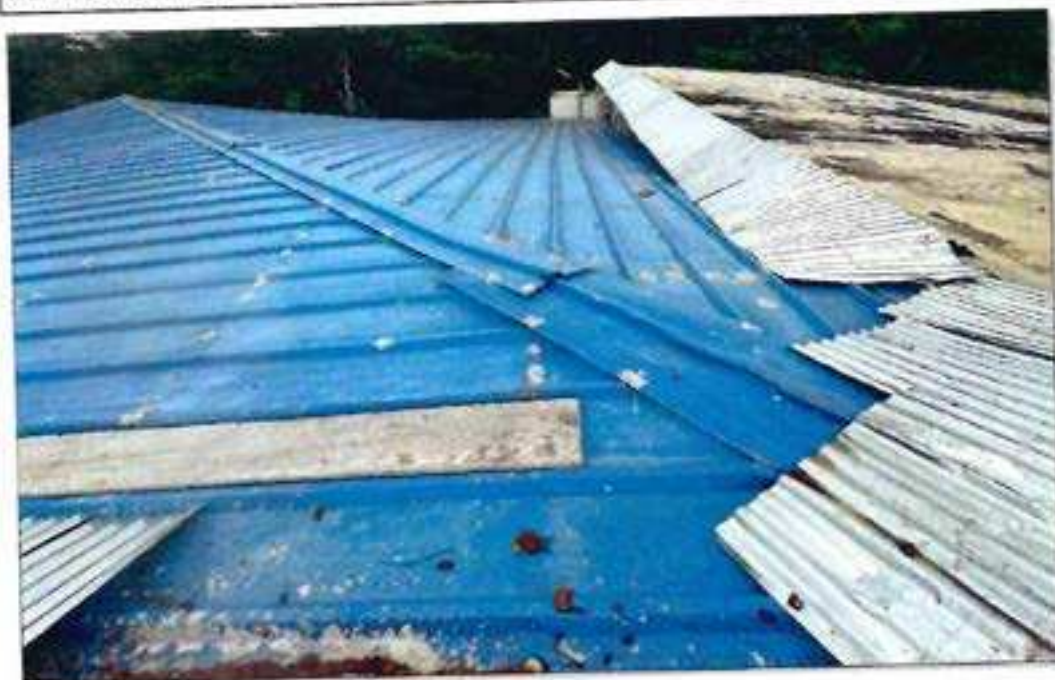
Imagen 05. La cobertura metálica presenta un mal proceso constructivo e inadecuado materiales, la cual no ha garantizado un funcionamiento óptimo provocando filtraciones pluviales.
