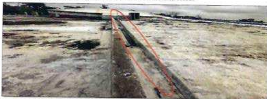
Imagen 01. La canaleta entre el bloque A y bloque B, presenta fisuras y grietas generando la filtración de aguas pluviales a los niveles inferiores.
