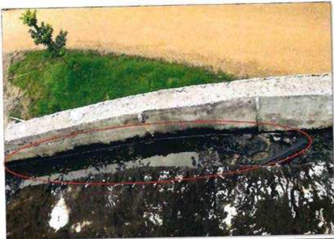
Imagen 03. La canaleta perimetral del techo presenta obstrucción con tierra, escombros y maleza que a lo largo del tiempo fue acumulándose, generando el estancamiento de las aguas pluviales y esto a su vez generando filtraciones.
