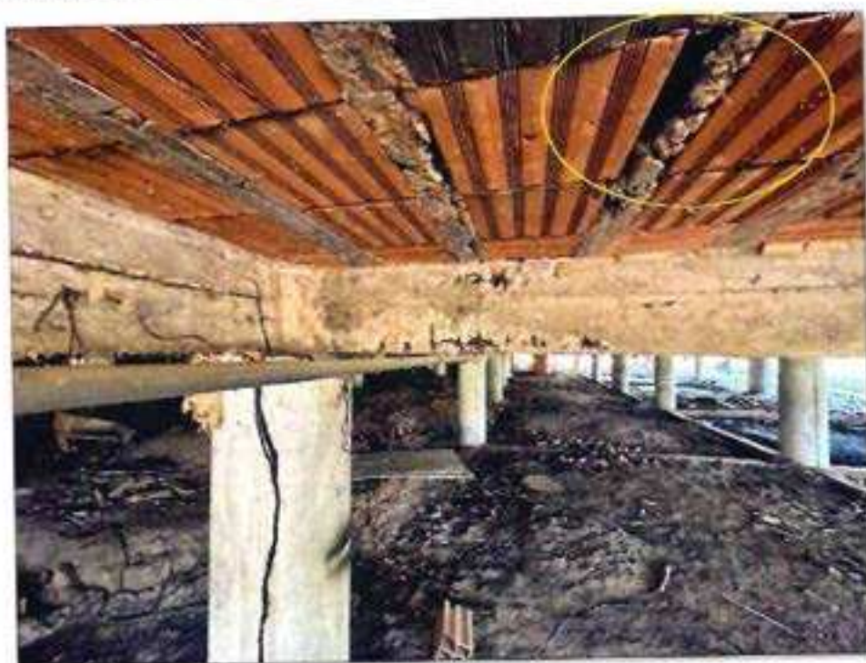
Imagen 09. Presencia de cangrejeras en las viguetas de la losa aligerada.
