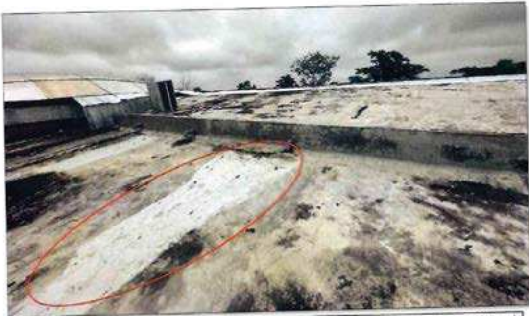
Imagen 02. La losa aligerada presenta fisuras y grietas. También presenta resane con mortero, lo cual no ha sido la solución a la filtración de agua.
