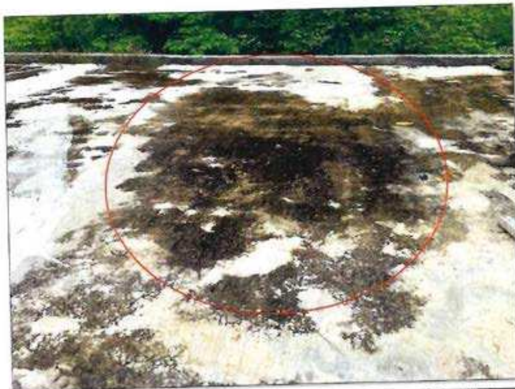
Imagen 04. La losa aligerada presenta impregnación de humedad, provocando filtración de agua haciendo que lo largo del tiempo provoque un daño estructural severo a la losa.
